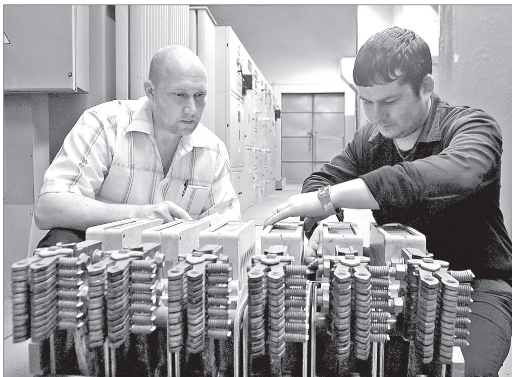
Мастер службы энергетика Виталий Вишницкий и Максим Молоков на трансформаторной подстанции
