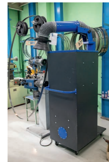
◀ Фильтровальная установка ФВУ-01-04
